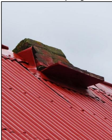
Inward collapse, Waiau
