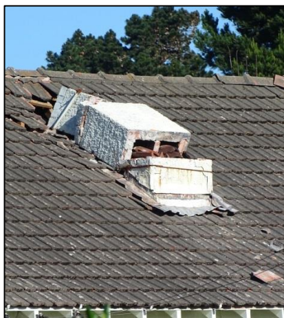
Inward collapse, Clarence
