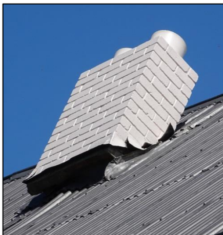
Inward collapse, Blenheim
