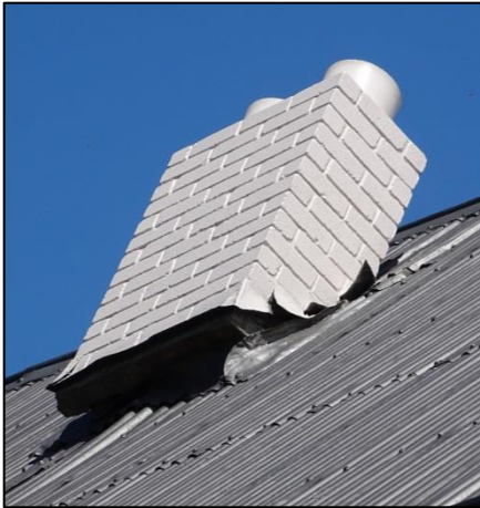
Inward collapse, Blenheim
