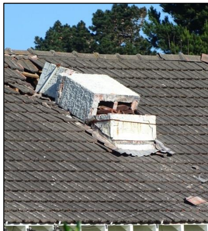
Inward collapse, Clarence
