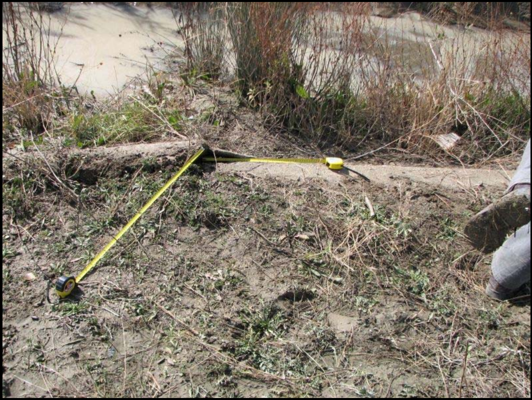
Foto A4. Van Organize Sanayi Bölgesi KD’sunda Van Fayı’nın bir sulama kanalını (L5) kestiği bölümde beton kanalda meydana gelen deformasyon sonucu oluşmuş sıkışma. Sıkışmadan kaynaklanan kısalmanın miktarı 10 cm olarak ölçülmüştür.
