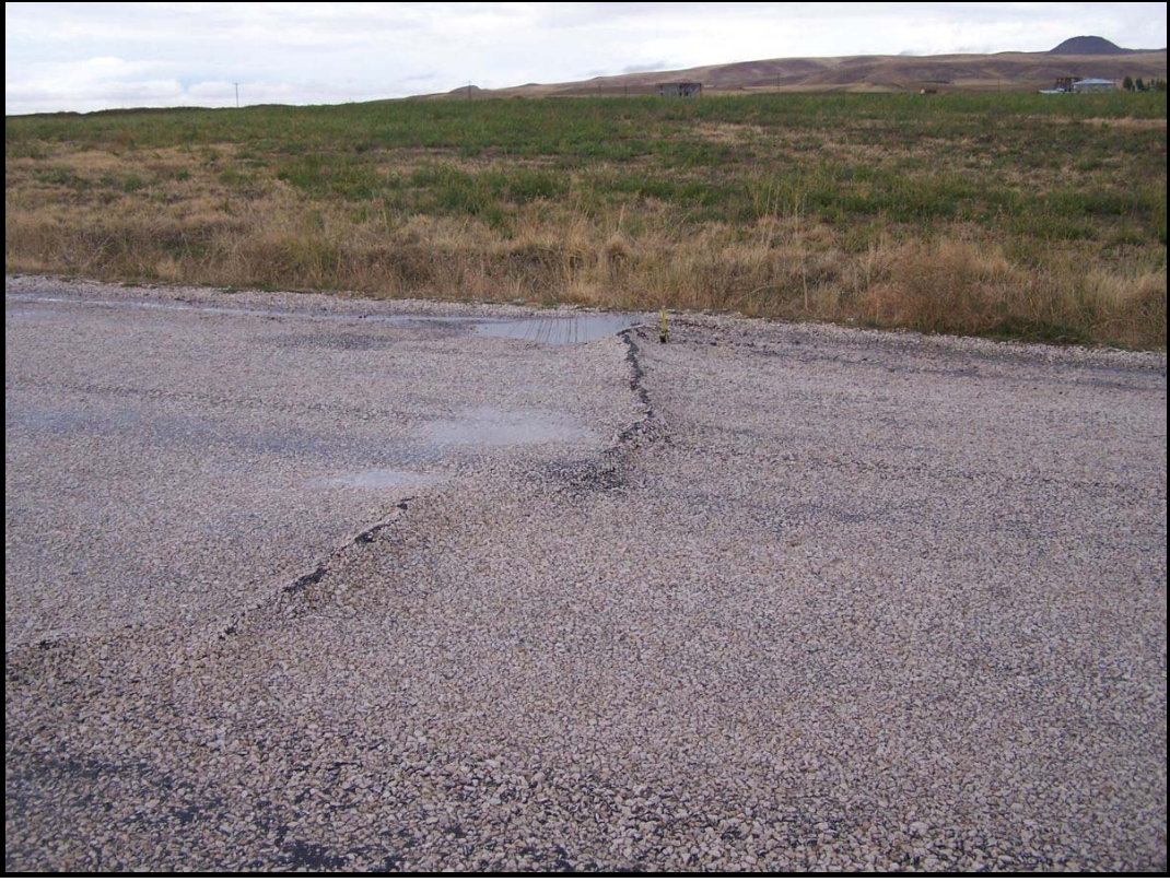
Foto A3. Foto A2’de gözlenen deformasyonların (L3) fay doğrultusu boyunca görünüşü. Bakış KD’yadır. Asfalt zeminde kıvrım şeklinde deformasyonlar gelişmiş olup, tavan blok (sol) ortalama 10 cm yükselmiştir.
