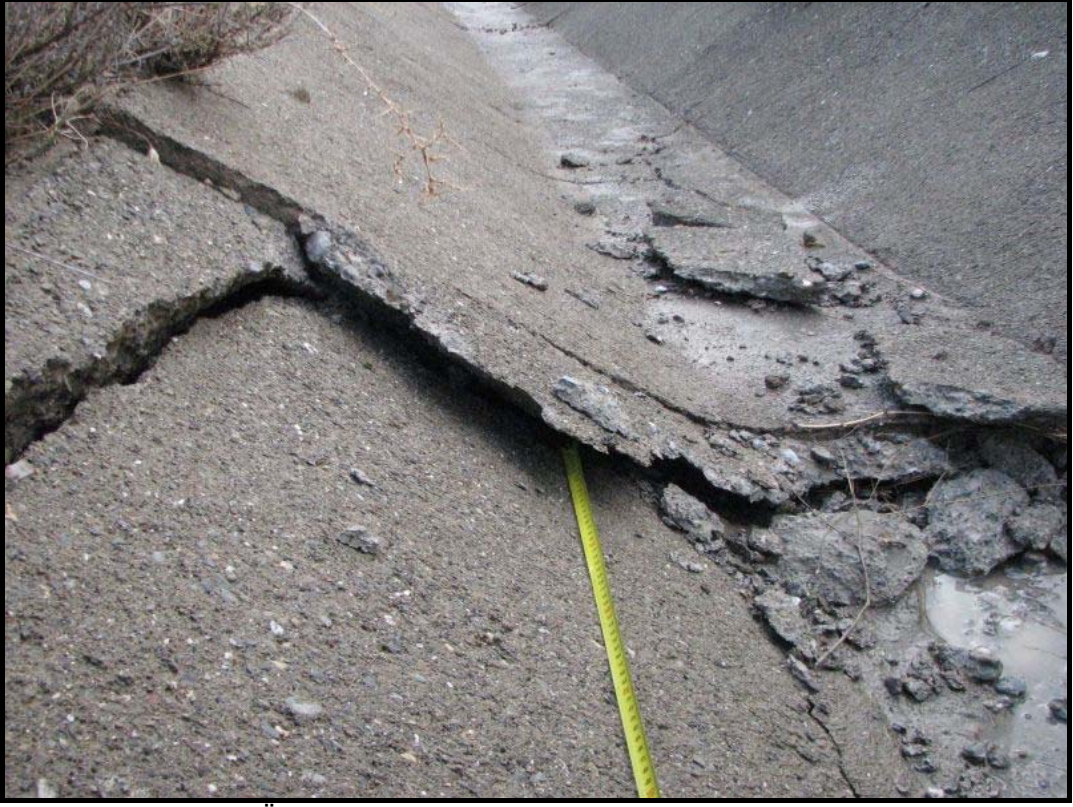
Foto A5. Van Yüzüncü Yıl Üniversitesi ile TRT vericisi arasındaki bir sulama kanalında (L4) Van Fayı'na dik uzanan sulama kanaletinde sıkışma sonucu gelişmiş deformasyon. K-G yönde 10 cm kısalma ölçülmüştür.
