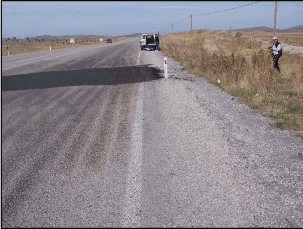
Foto C10. Güvençli doğusundaki bataklık alanda yanal yayılma nedeniyle Van-Erciş karayolu üzerinde meydana gelen deformasyon. Bakış KD'ya. Doğu yol kenarı çizgisinde doğudakinde yanılıcı sola ötelenme gözlenmesine rağmen batı kenar yol çizgisinde hiçbir yerdeğiştirme gelişmemiştir.
